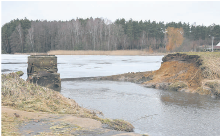
Zniszczony wał między stawami
